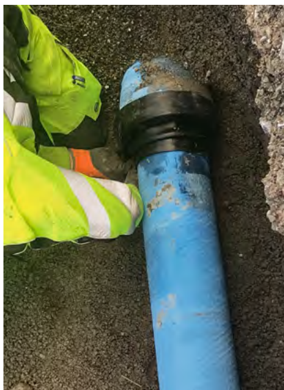
Die Verbindung zweier Rohre mithilfe des leicht zu montierenden BLS-Systems. Mit dem Anbringen der Gummimanschette erfolgt der finale Schritt.
